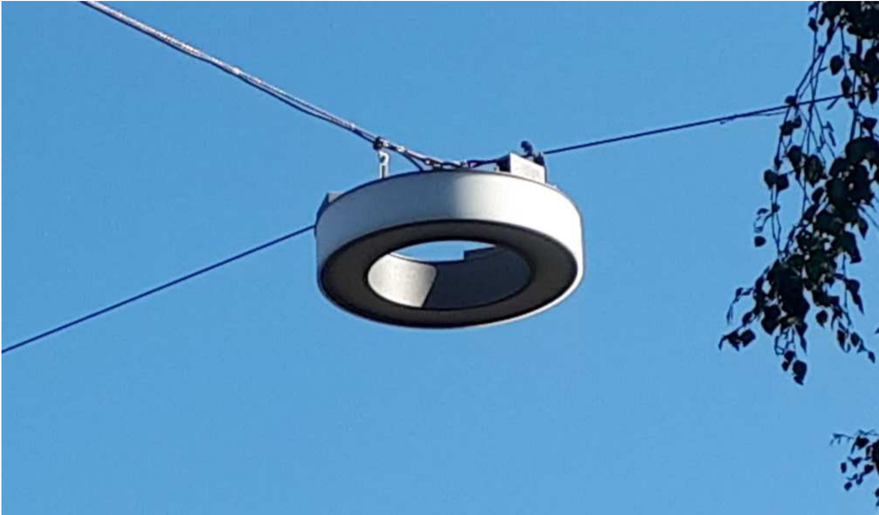
Neugestaltung Königsstraße | Beleuchtung
