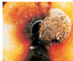
in den Kanal eingedrungene Wurzeln
